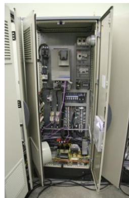
Шкаф управления электроприводом подъема крана грузоподъемностью 90т
